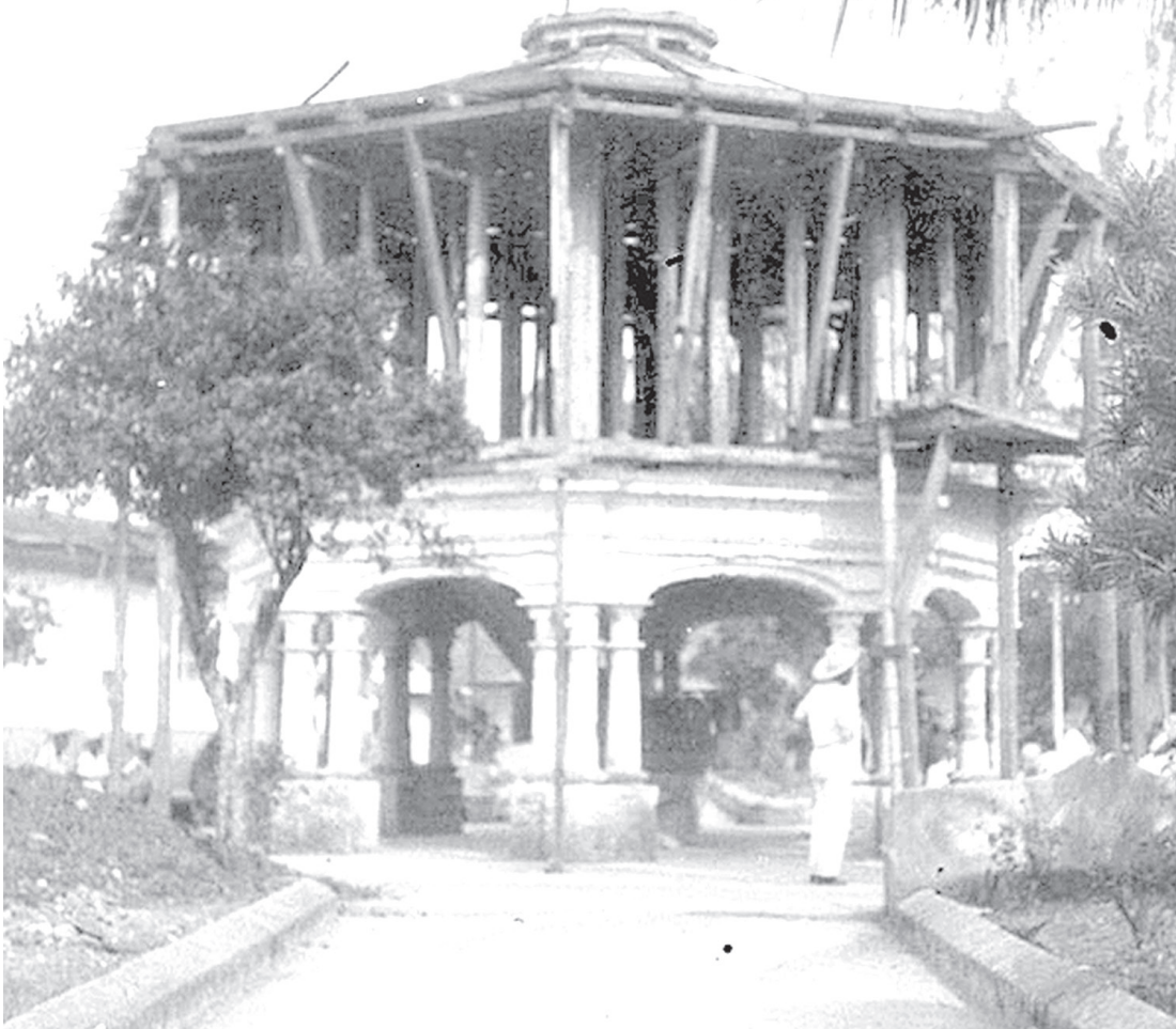
En los cuarentas se construyeron las columnas, el techo y la balastrada del segundo piso del kiosco.
